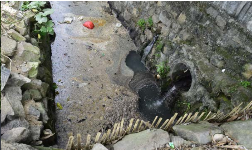
Das Abwasserrohr eines Hauses in Zhuhai wird in einen offenen Abwasserkanal ausgeleitet
