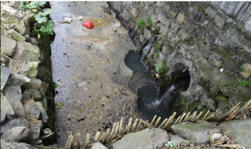
Aguas residuales de una casa de Zhuhai vertiendo en una cloaca a cielo abierto.
